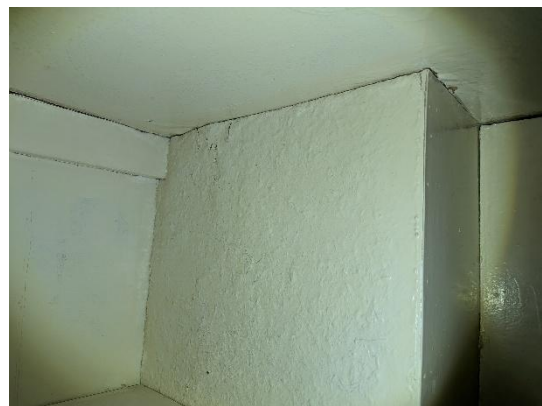
Formförändring på schakt i garderob.
