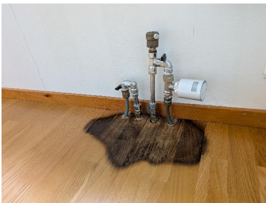
Missfärgning på golv i sovrum.
