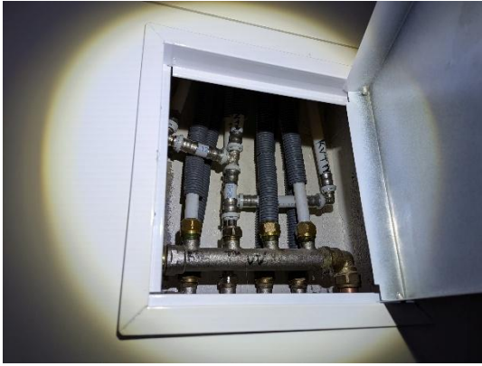
Tappvatteninstallationer i schakt.
